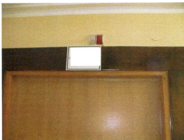
Lampki alarmowe instalacji przyzywowej
