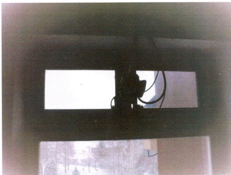
Zastosowany obecnie system oddymiania - uchylna górna część okna.
